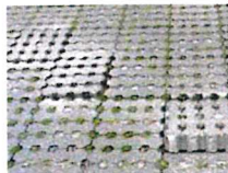
Loose Platten auf dem Bad Köseener Parkplatz neben dem dortigen Tierpark FOTO: CHARLOTTE GERECHT
